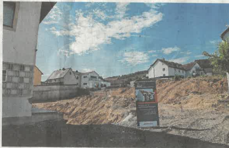
Noch klafft eine riesige Baulücke in Erlabrunns Ortskern: Entstanden war die Fläche durch den Abbruch von Scheune und Nebengebäuden, die dem Hotel und Weinhaus Flach (links) angegliedert waren. FOTO: HERBERT EHEHALT
